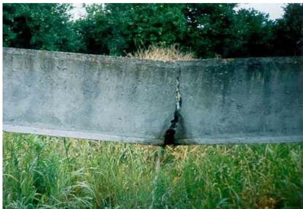
Fotografía 1. Canal de riego con fugas
